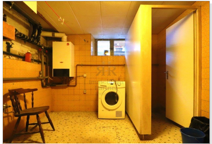
Heizungs- und Waschkeller
