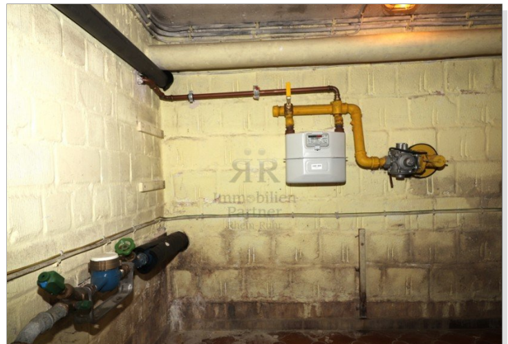
Gaszähler und Hauptwasserleitungen
